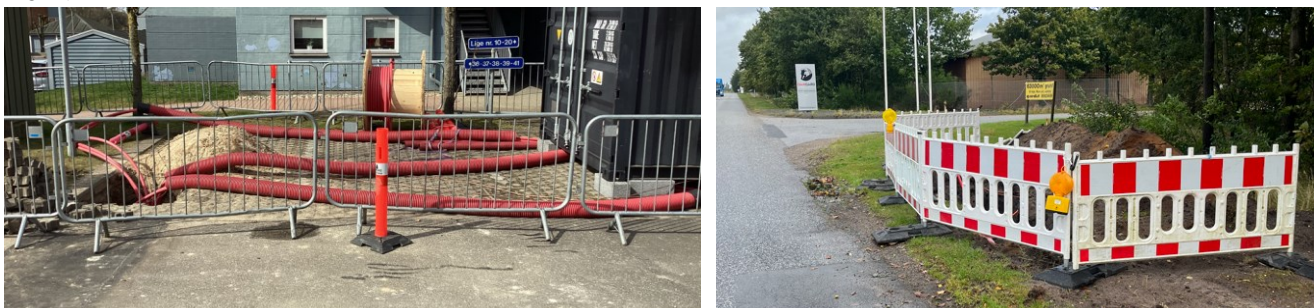
Figur 5: Viser 2 eksempler på korrekt mekanisk beskyttelse af blotlagte og spændingssatte kabler
